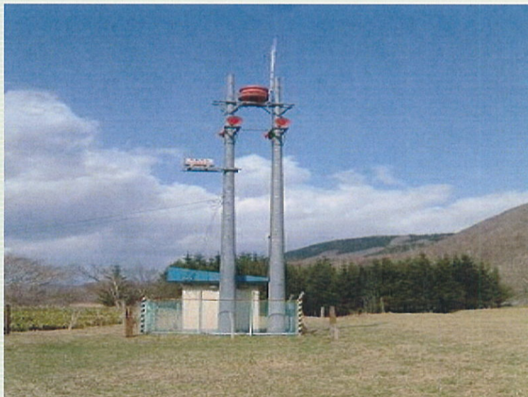
【警報局】 大雨洪水時にサイレンやスピーカーにより河川周辺へ危険を知らせます。
