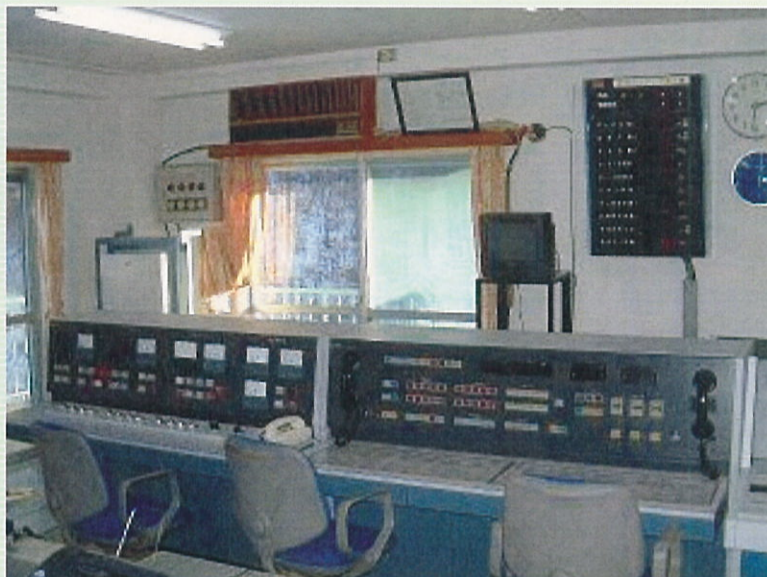
【ダム管理所】 ダムの水位、ダム湖への流入量、ダムからの放流量等を管理しています。洪水時のゲート操作卓、警報発信装置を備えています。
