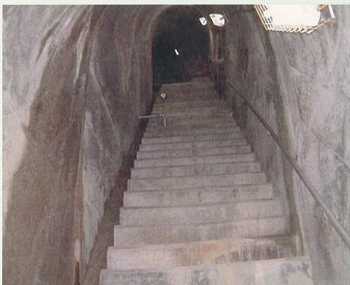
【監査廊】 ダム堤体の基礎から漏水量や揚圧力を観測しダムの安定を確認します。
