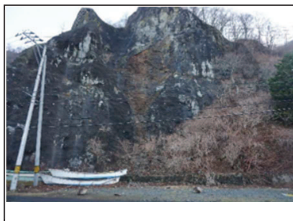
老朽化施設(山腹工)
