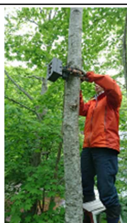
監視カメラ設置
